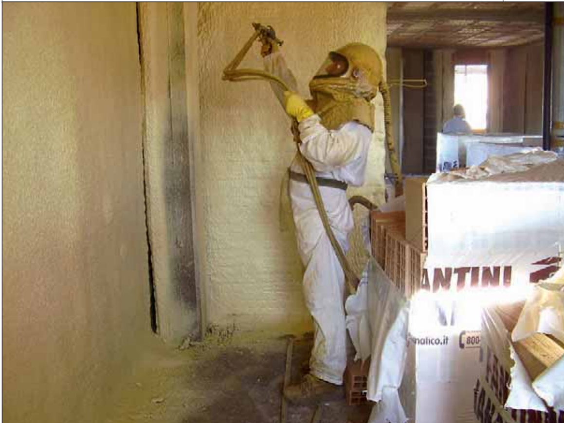
Operatore con scafandro a cappuccio che spruzza in prossimità di un pilastro
