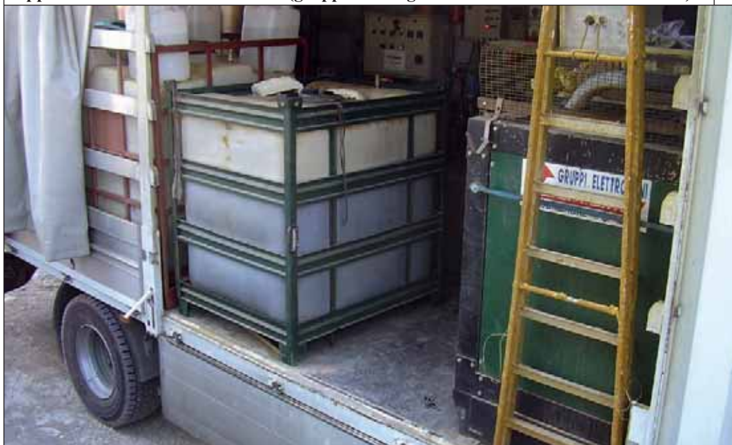
Apparecchiature dell'unità mobile (gruppo elettrogeno - contenitore sostanza chimica)
