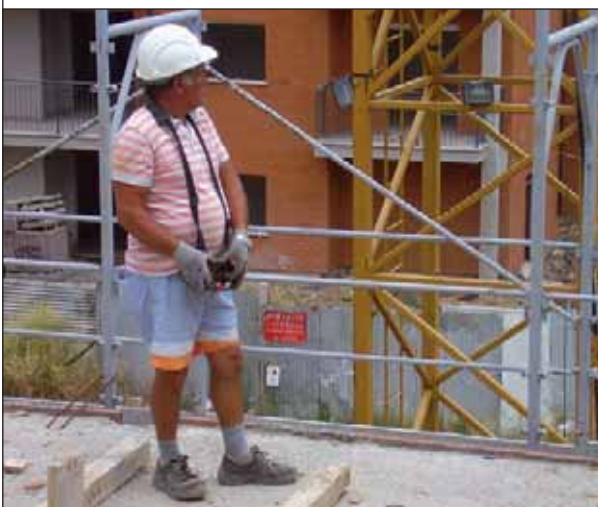
Gruista con telecomando alla manovra
