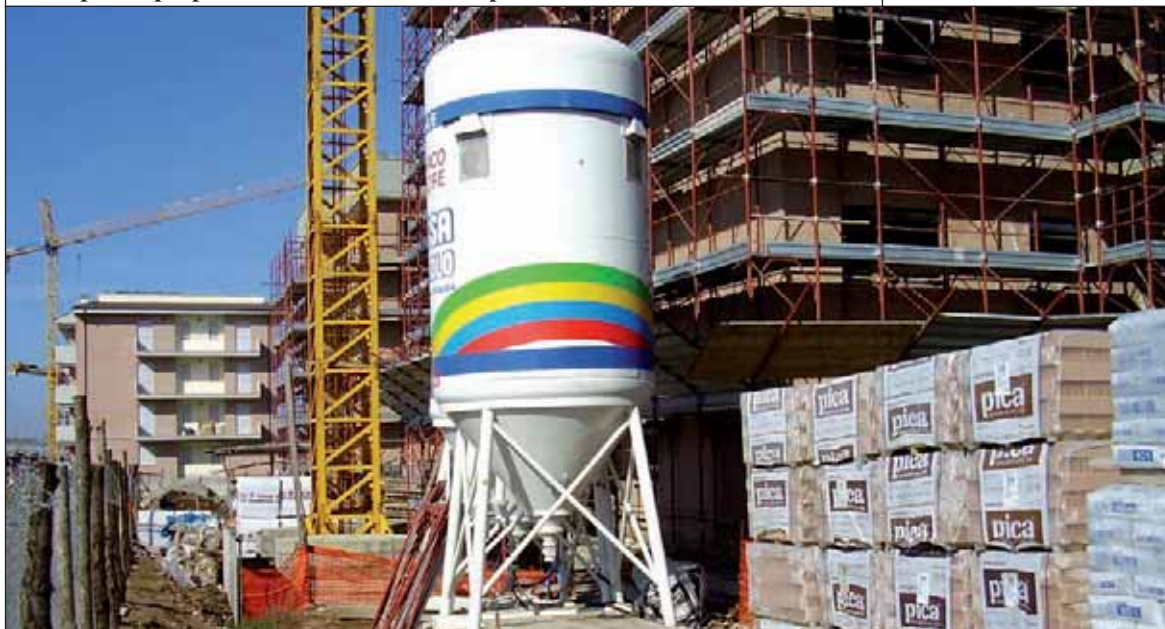
Silos per la preparazione delle malte e deposito laterizi e sacchi di malta
