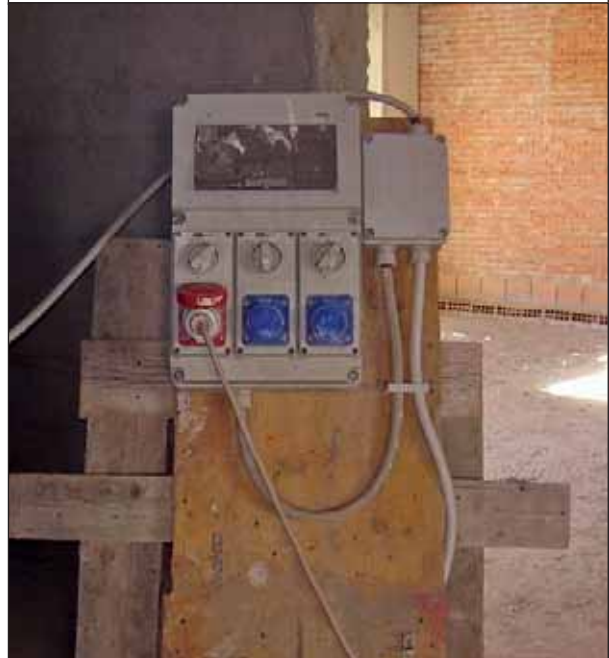
Quadretto elettrico di cantiere IP 44
